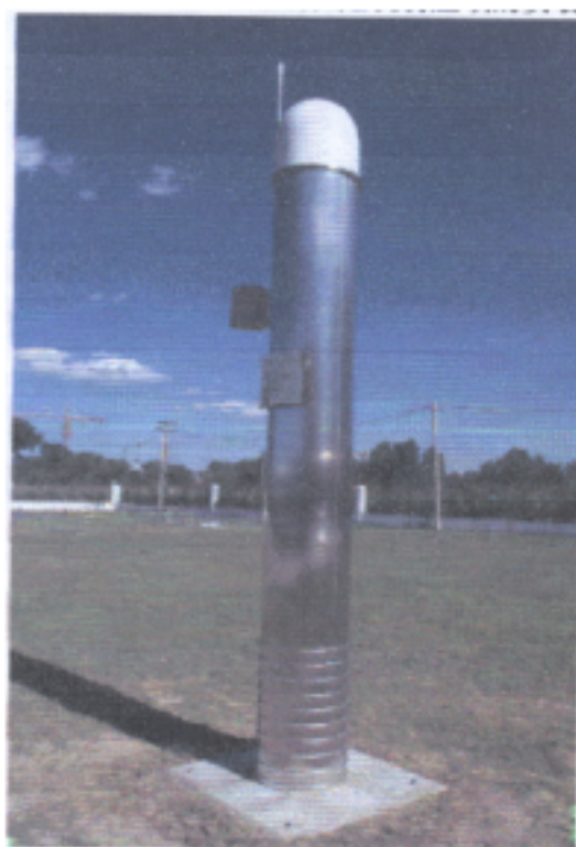
图 5.2.3—5 GPS 基准站天线在地面的安装实例
