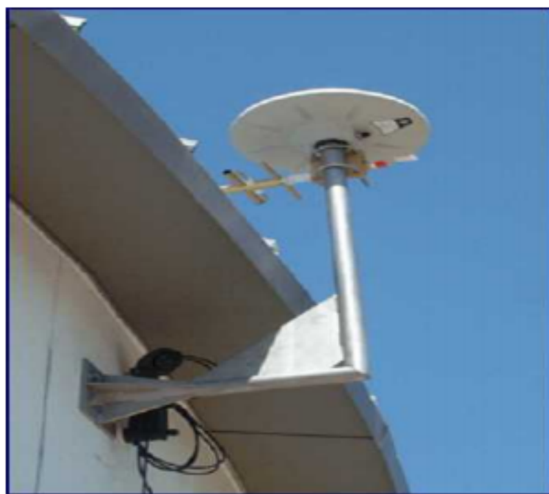
Trimble Zephyr Geodetic 天线安装在台站屋顶，接驳避雷设施
